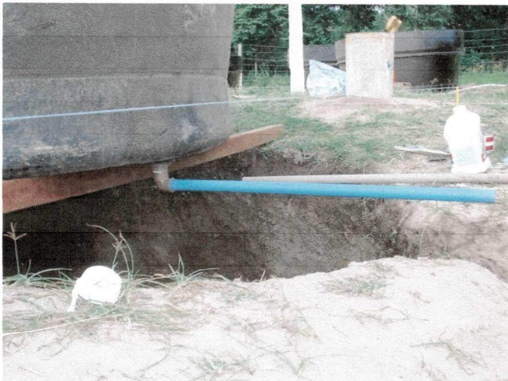
Figura 3.5 - Tubulação de PVC soldável de 25 mm conectada no fundo da caixa.
