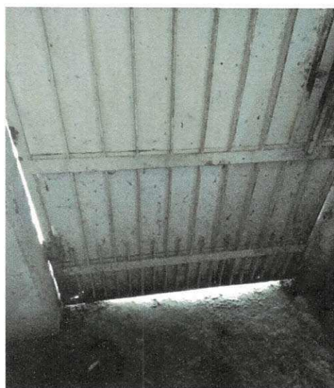
Figura 24: Porta com brecha que dá acesso a área externa do ambiente
