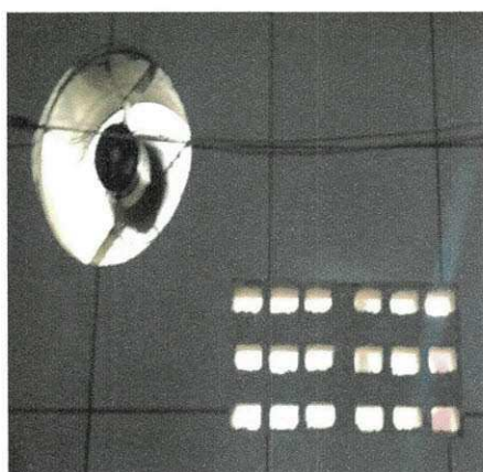
Figura 32: Pontos de ventilação sem proteção de tela
