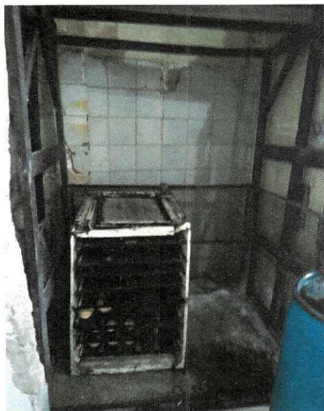
Figura 14: Elevador em más condições onde os pães eram transportados
