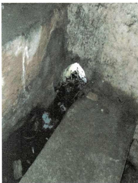
Figura 21: Buraco aberto localizado em uma parede dando acesso a parte interna a parte externa do local
