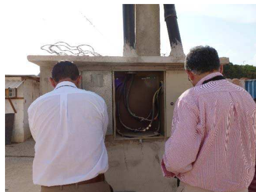
Figura 11 — Mureta da subestação clandestina com visão da caixa de medição ao centro, sem o sistema de medição.
