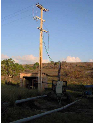
Figura 29 — Visão de transformador, instalado em base móvel, conectado na rede de MT.
