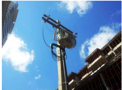
Figura 13 — Visão inferior do transformador da subestação clandestina mostrada na Figura 12.
