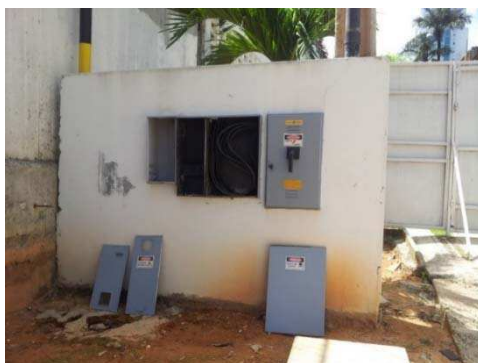
Figura 14 — Mureta da subestação clandestina (Figura 12) com visão da caixa de medição ao centro, sem o sistema de medição.
