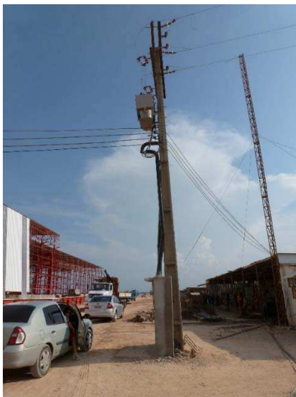
Figura 10 — Subestação clandestina conectada à rede de distribuição primária em MT.
