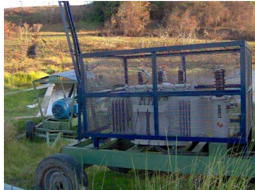
Figura 30 — Visão aproximada do transformador, instalado em base móvel, apresentado na Figura 29.
