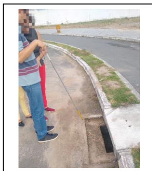
Figura 13 – Bueiro aberto na pista de caminhada do Parque da Liberdade
