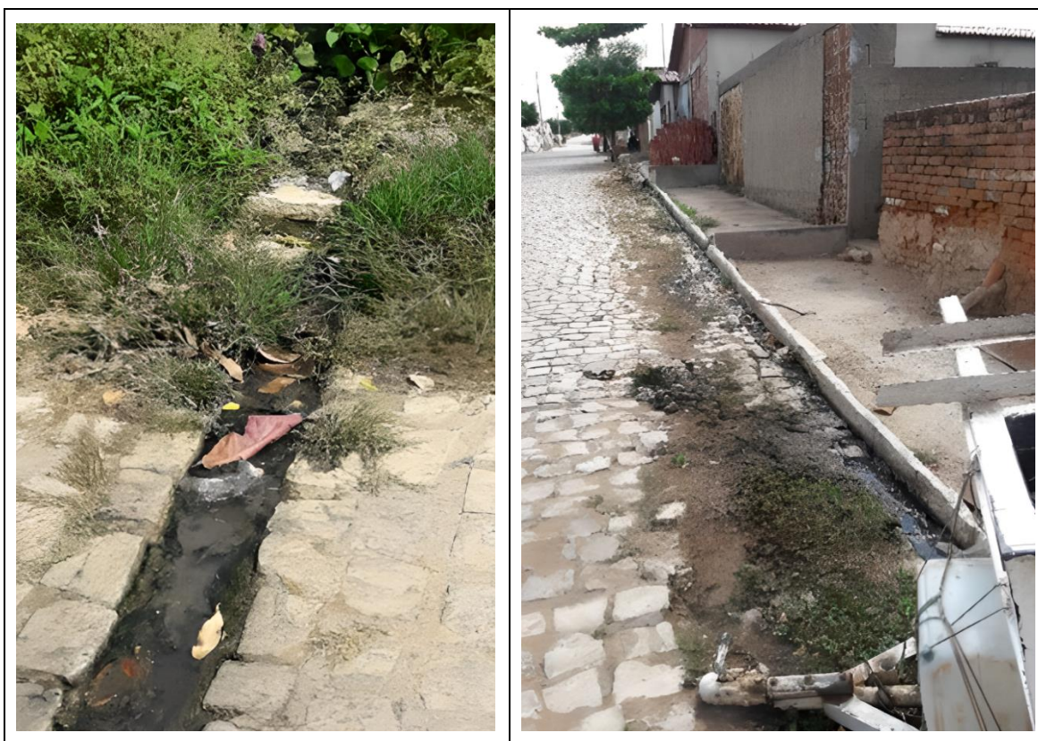
Figura 09 - Esgotos lançados a céu aberto na rua Primo Cajé.
