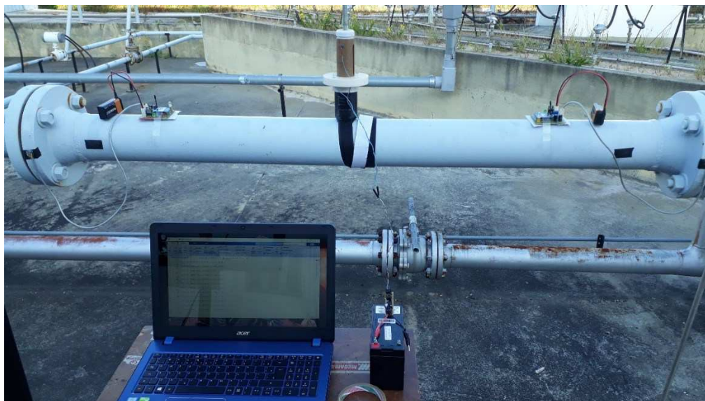
Figura 4.10: Foto Ilustrativa das tubulações do LAMP: aço carbono suspensas.
