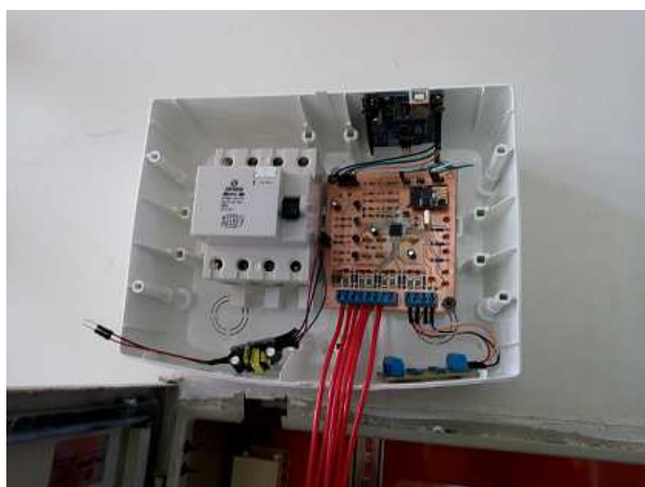
Figura 2.4 – Medidor inteligente instalado no Bloco CJ da UFCG.
