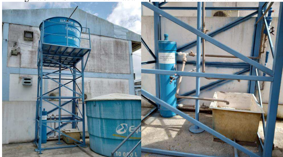
Figura 32 – SALTA-z utilizada na pesquisa instalada na ETA-Mará
