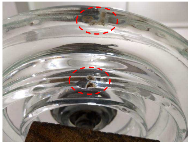
Figura 54 – Fotografia do revestimento S100 com indícios de danos provocados por descargas disruptivas e bandas secas.
