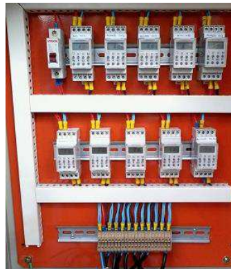
Figura 15 - Quadro de temporizadores
