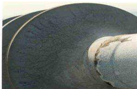
Figura 6 - Exemplo de fissuras nas abas do revestimento.
