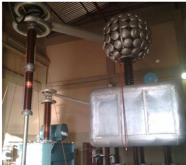
Figura 26 - Fotografia do transformador a ser utilizado nos ensaios.
