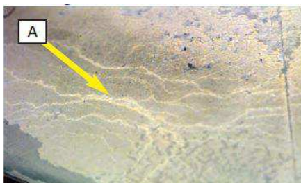
Figura 7 – Fotografia com exemplo de fissuras nas abas do revestimento.
