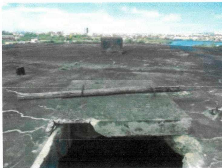
Figura 18 – Imperfeições na estrutura do reservatório principal do campus Campina Grande da UFCG.
