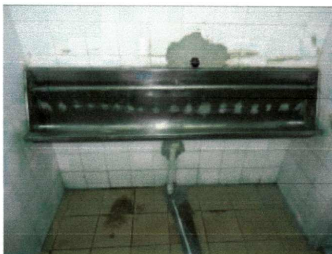
Figura 16 – Mictório coletivo do Bloco CQ do campus Campina Grande da UFCG.
