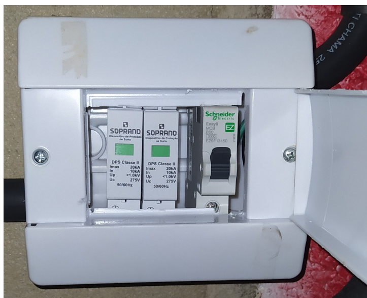
Figura 25 – Dispositivos de proteção CA implementados no sistema fotovoltaico.
