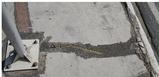
Figura 4: Eletroduto enterrado em baixa profundidade no piso.
