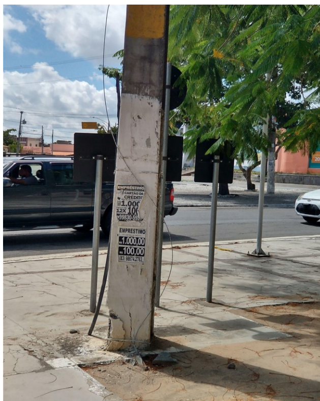
Figura 6: Condutor de aterramento sem fixação e sem eletroduto.
