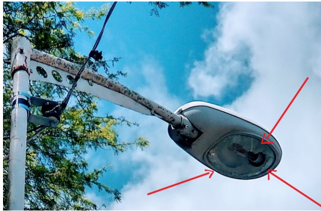
Figura 7: Poste de iluminação com luminária quebrada e lâmpada queimada.
