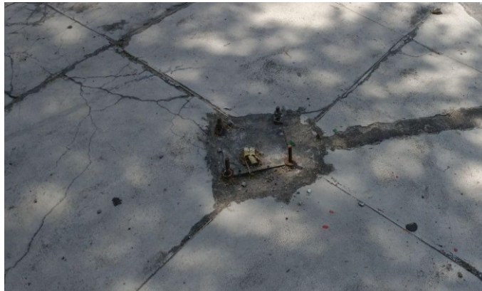
Figura 8: Ausência de poste em local com fundação apresentando parafusos aflorados.
