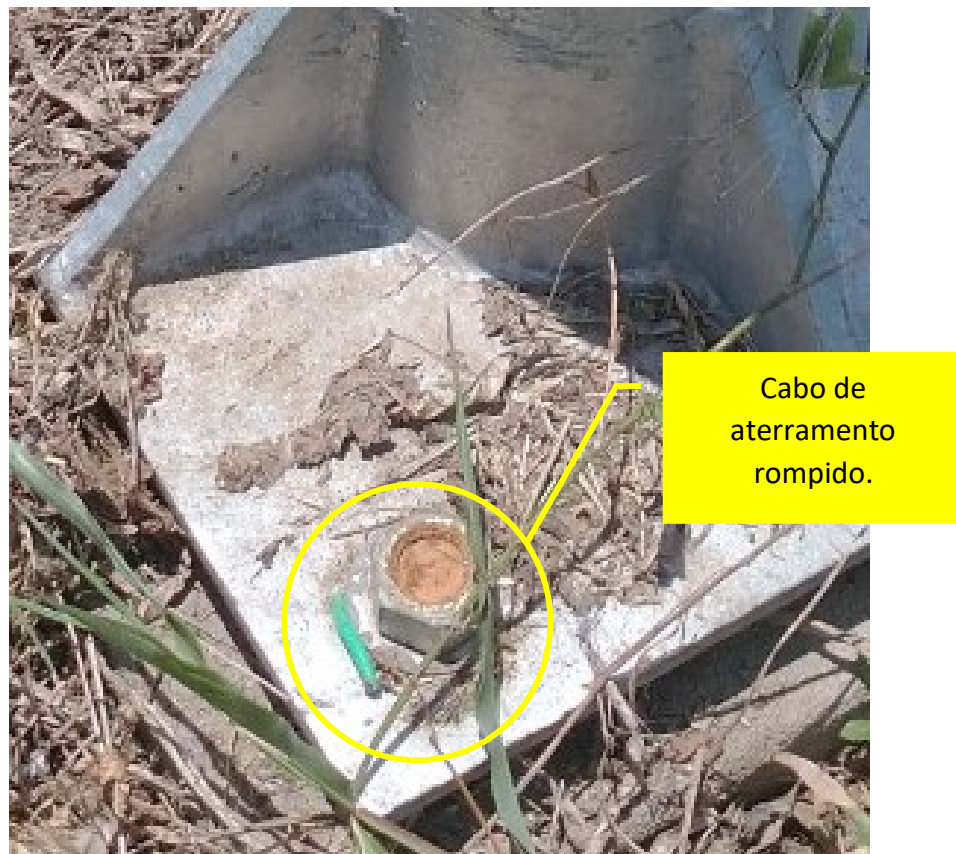
Figuras 19: base de poste com aterramento rompido na Alça Leste.
