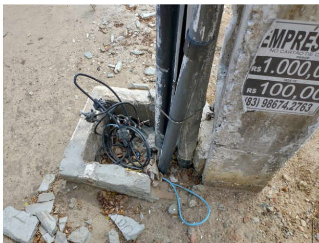
Figura 5: Caixa de passagem com estrutura avariada, sem tampa e condutores expostos.
