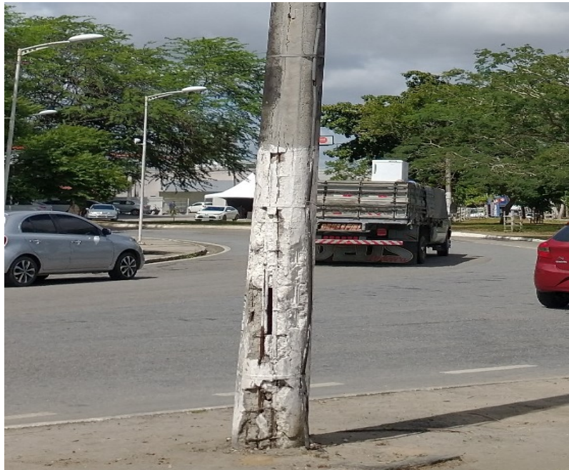
Figura 11: Poste da rede de distribuição e iluminação com avarias.
