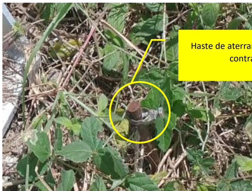
Figuras 20: base de poste sem caixa de aterramento na Alça Leste.
