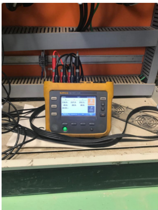
Figura 18: Medição realizada com equipamento Fluke
