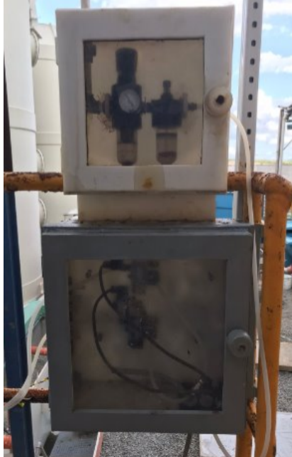
Figura 23: Proteção das válvulas
