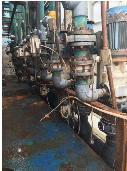
Figura 16: Conjunto de Bombas
