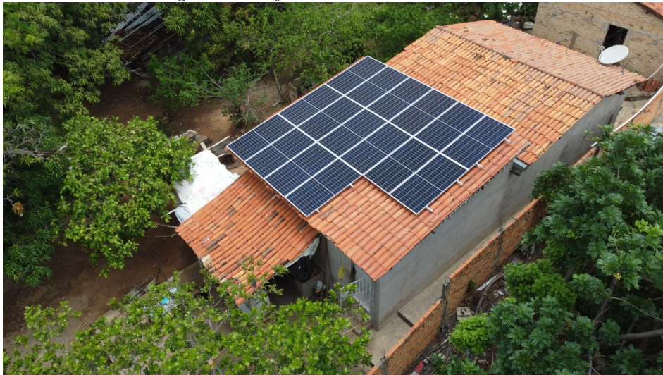
Figura 7: Conjunto de módulos instalados.
