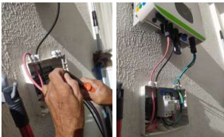
Figura 11 – Inversor e String Box
