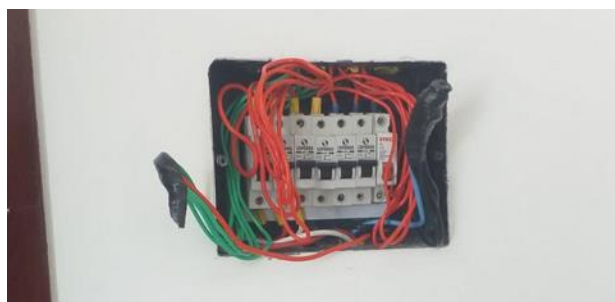
FIGURA 19 - QUADRO DE DISTRIBUIÇÃO DA RESIDÊNCIA
