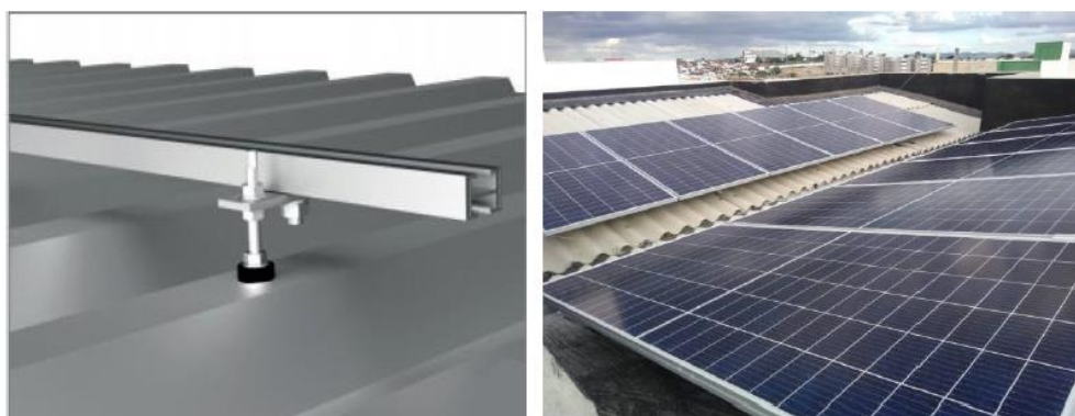
Figura 10: Módulos fotovoltaicos em telhas de fibrocimento.
