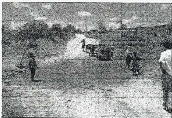
Foto 36: Cova do Casado local onde deveria haver uma passagem molhada, que foi construída, mas devido às últimas chuvas a mesma foi arrastada pelas águas do riacho.
