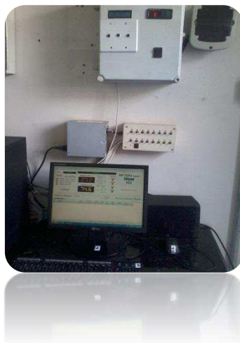
Figura 2 – Instrumentos e equipamentos instalados na câmara climática.
