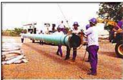
Figura 2.2 – Canos que compõem a rede de gasoduto para o transporte do gás natural.
