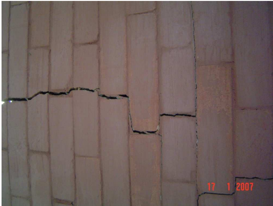
Figura 4.4 – Vista das rachaduras do forno durante os processos de secagem e queima.
