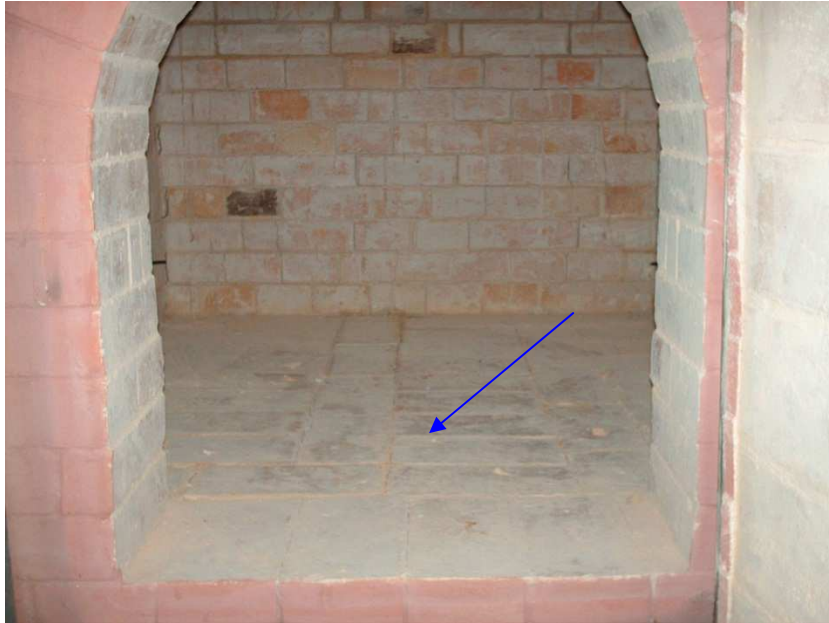
Figura 4.6 – Vista das rachaduras internas do forno. Fonte: Próprio autor (2007).
