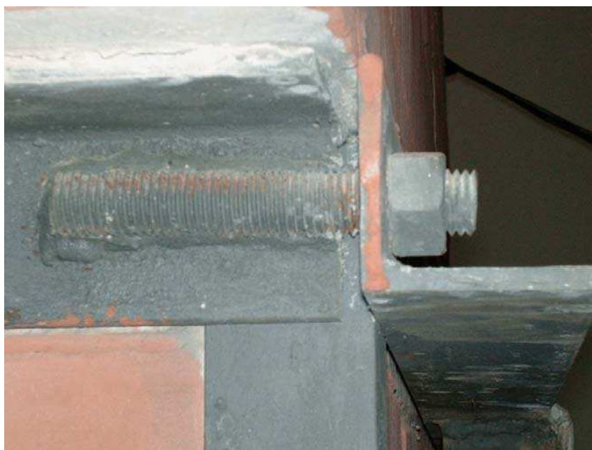
Figura 3.5 – Vista lateral do parafuso que prende a cantoneira de ferro ao forno. Fonte: Próprio autor (2005).
