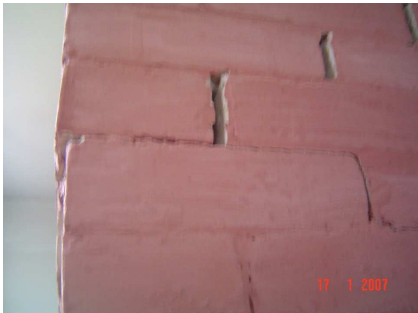
Figura 4.3 – Vista das rachaduras na parte superior do forno. Fonte: Próprio autor (2007).
