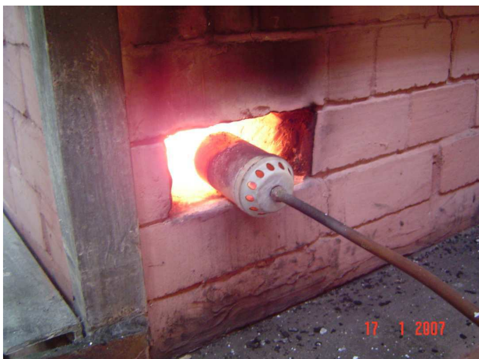
Figura 3.10 – Vista de um queimador operando com gás natural no forno construído com tijolo refratário. Fonte: Próprio autor (2007).
