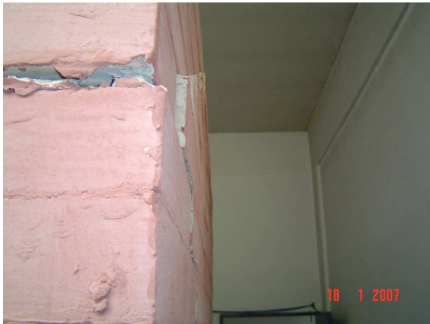
Figura 4.5 – Vista lateral das rachaduras do forno. Fonte: Próprio autor (2007).
