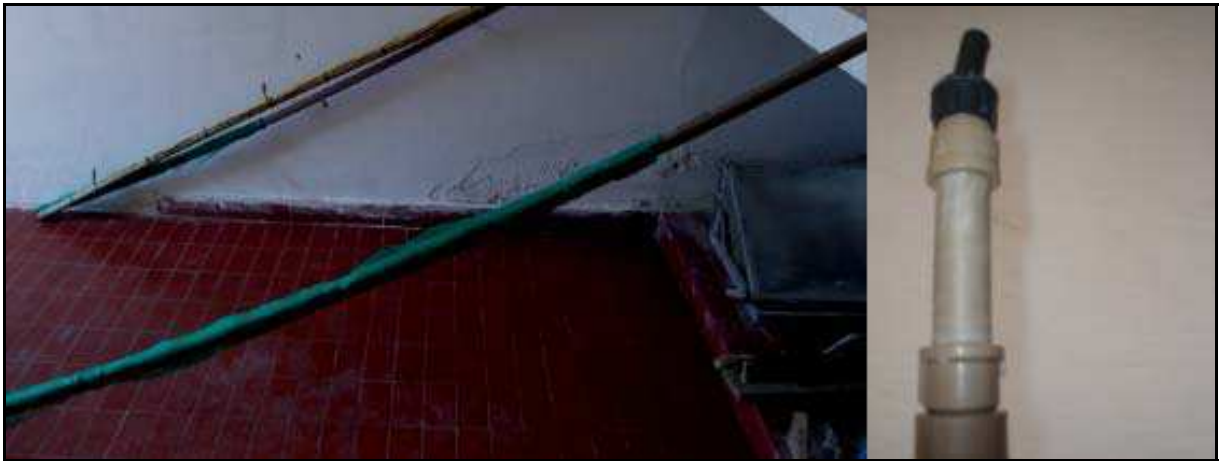
Figura 24 - Sistema de drenagem de gases.
