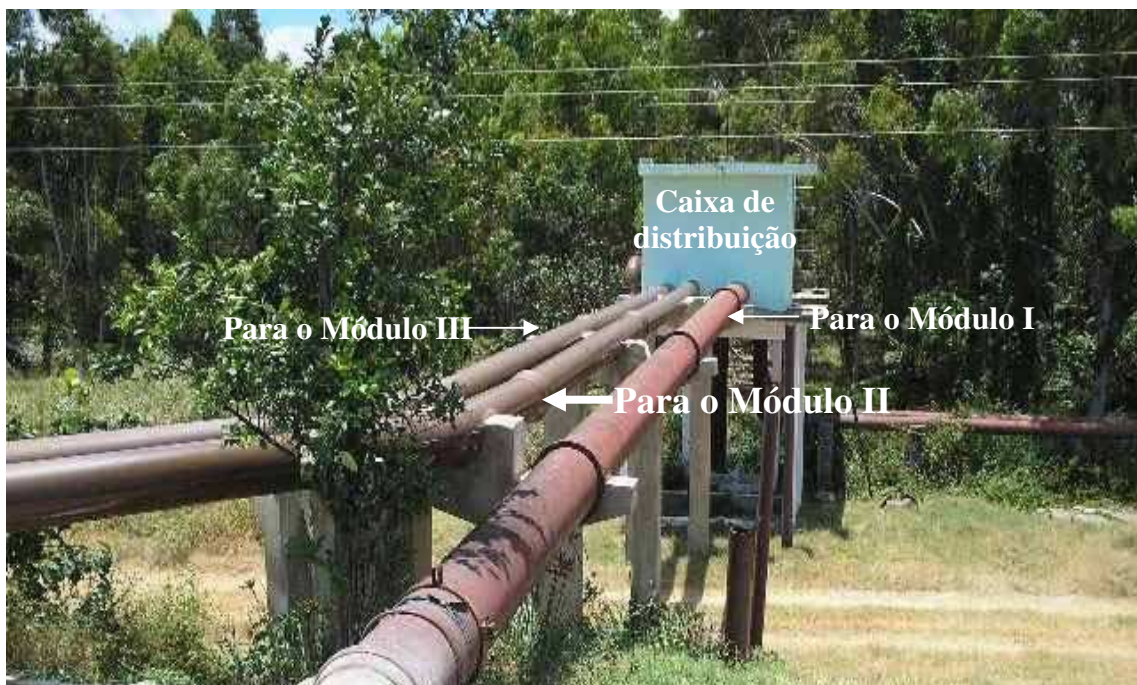
Figura 4.5 - Caixa de distribuição de esgotos.
