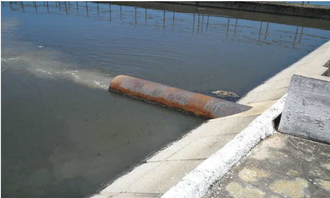
Figura 4.6 - Tubo de descarga do afluente na primeira lagoa anaeróbia.
