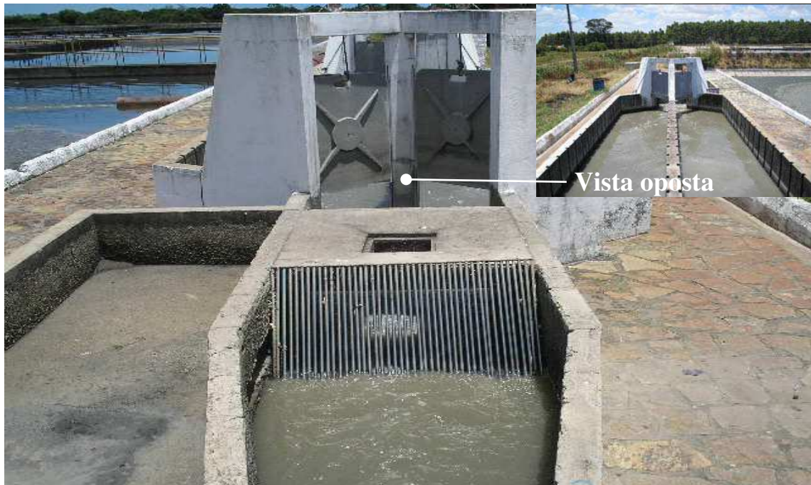
Figura 4.3 - Tratamento preliminar destacando-se o gradeamento em primeiro plano.
