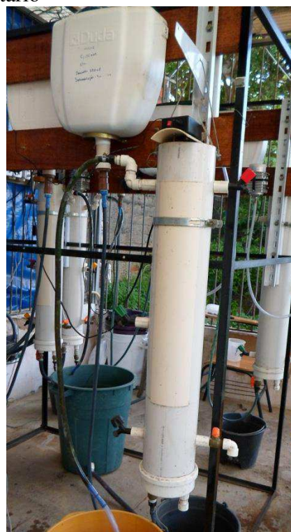
Figura 3.6: Foto do sistema RBS Unitário
