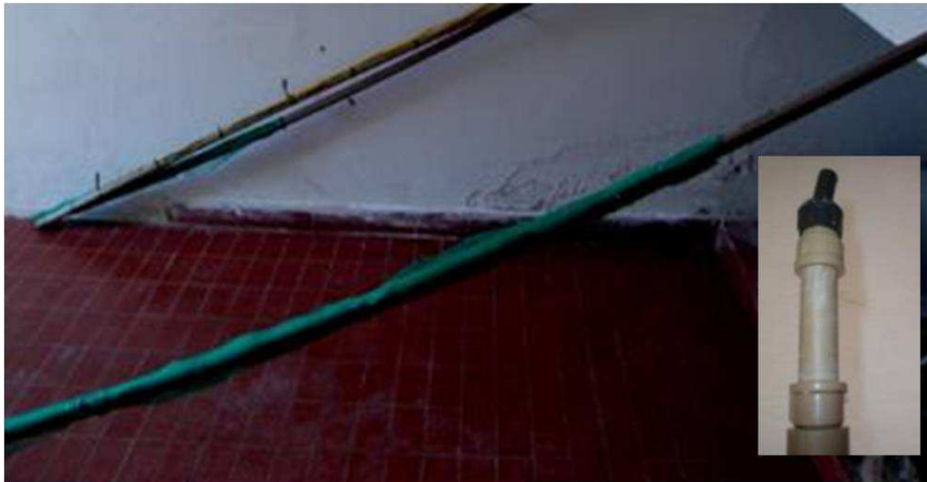
Figura 15: Sistema de drenagem de gás.
