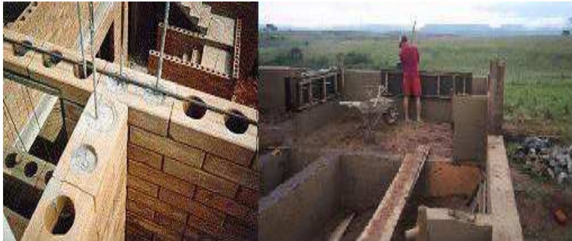
Figura 2.6: (a) Construção com tijolos de solo-cimento (b) Construção de paredes monolíticas de solo-cimento (Fonte: CAMPOS, 2007).
