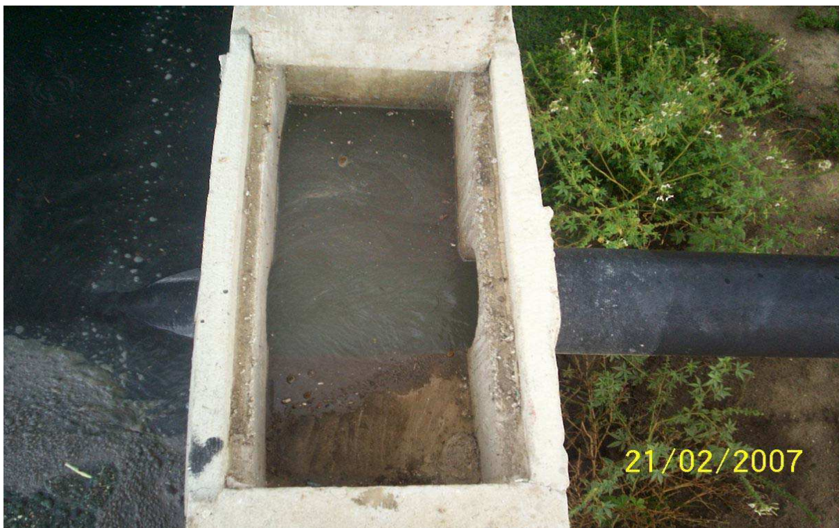
Figura 4.12 – Alimentação da lagoa anaeróbia.
