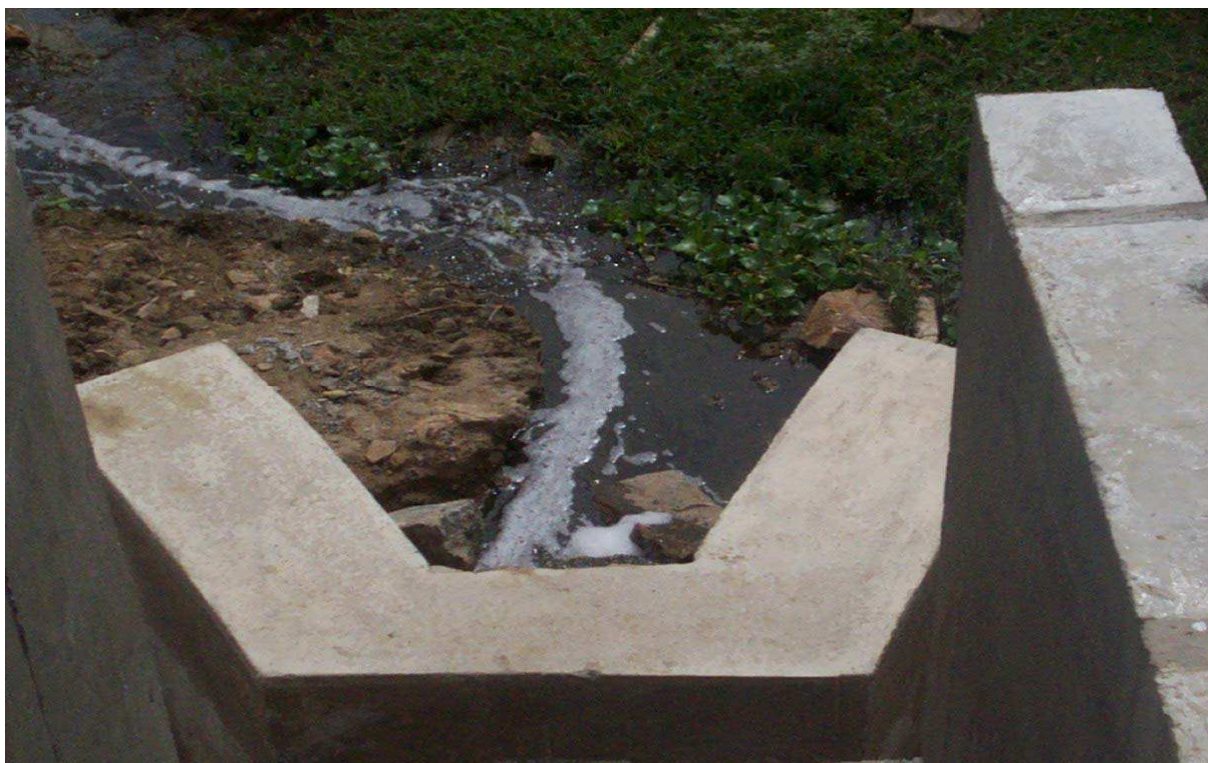
Figura 4.15 – Efluente desaguando no riacho Cardoso
