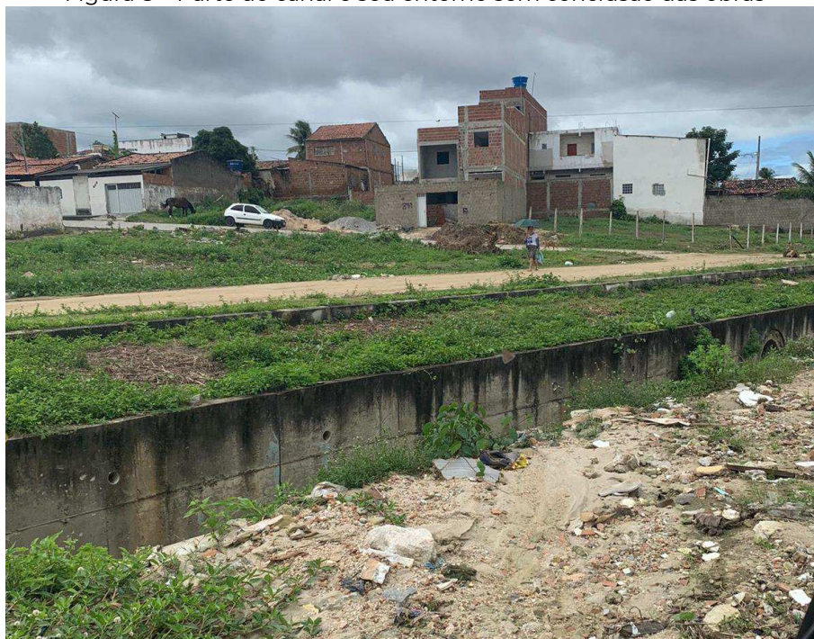
Figura 8 – Parte do canal e seu entorno sem conclusão das obras
