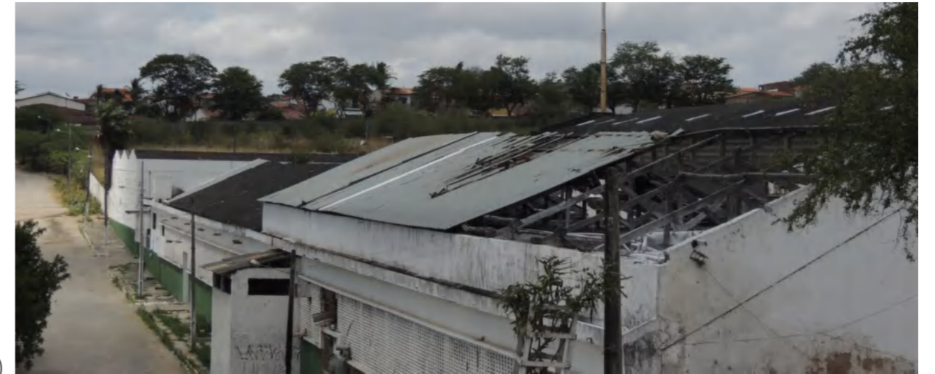
Fig. 40 | (a) perspectiva da Fábrica da Ipelsa - Indústria de Celulose e Papel da Paraíba S/A, em Bodocongó; (b) estado de conservação de parte do telhado da fábrica; (c) imagem de satélite da localização atual. Fontes: (a,b) Autor, 2019 / (c) Google Earth Pro, 2021.
