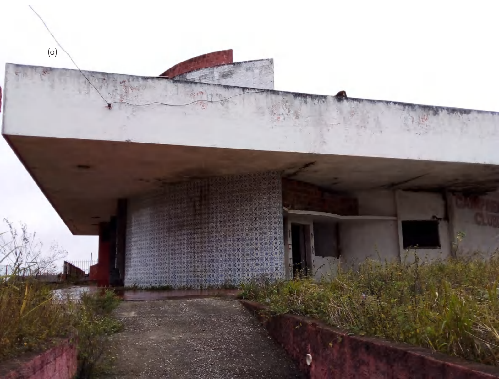
Fig. 83 | Composição imagética do estado de conservação da Boate Cartola, localizada no centro de treinamento do Campinense Clube. (a) perspectiva externa do acesso principal; (b) espaço interior dançante; (c) detalhe painel artístico em azulejos; (d) fachada posterior com acessos de saída. Fonte: Luma Gomes, 2021.
