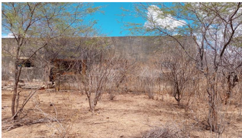
Figura 39 - Escola Manoel Genuíno de Araújo, Comunidade Bom Sossego (Desativada)
