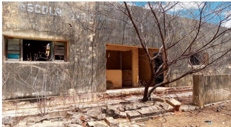
Figura 38 - Escola Manoel Genuíno de Araújo, Comunidade Bom Sossego (Desativada)
