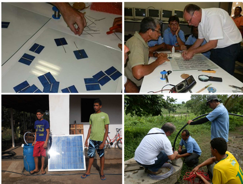
Figuras 9 a 12. Construção e implantação de painel solar - UDPAF do PA Penha I – Alagoa Grande.
