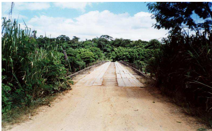
Foto 7.2: Local conhecido como Ponte Queimada, no limite entre os municípios de Marlièria e Pingo D'Água. Foto: Gidalzo Alves Sirqueira 5/2/2003.
