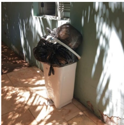
Figura – 23 Lixeira com inconformidade
