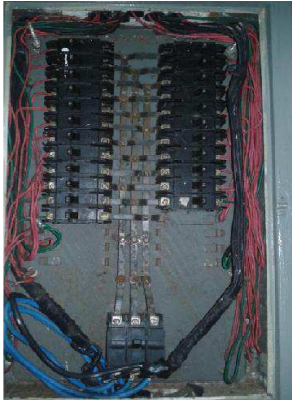
Figura 5 - Quadro de distribuição de energia em uma das unidades visitadas.
