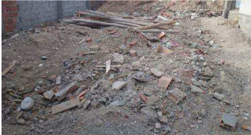
Foto 2: Ausência de separação dos entulhos por tipo.
