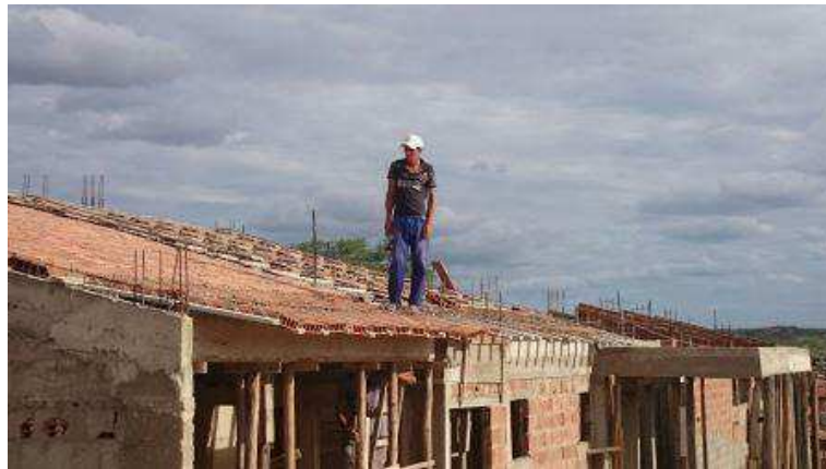
Foto 4: Trabalhador sem segurança adequada trabalhando em altura
