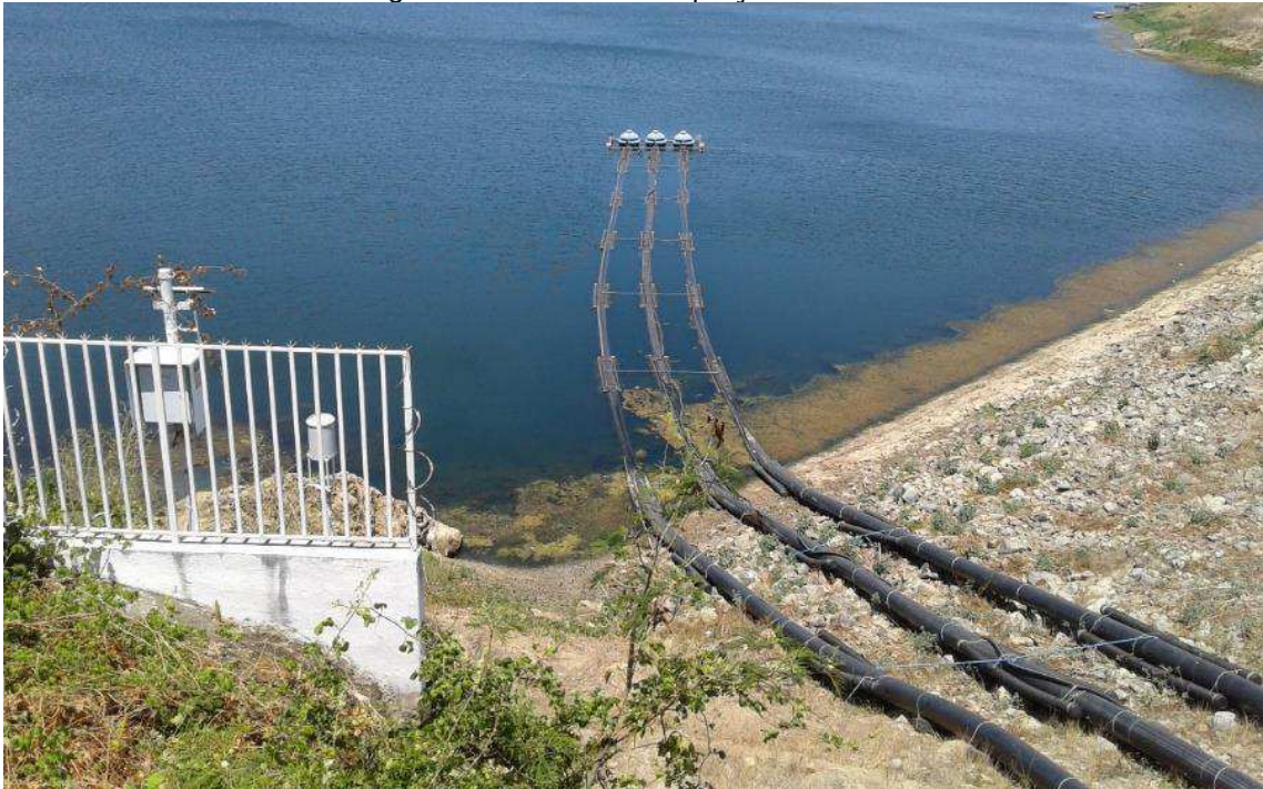
Figura 9 – Sistema de captação flutuante
