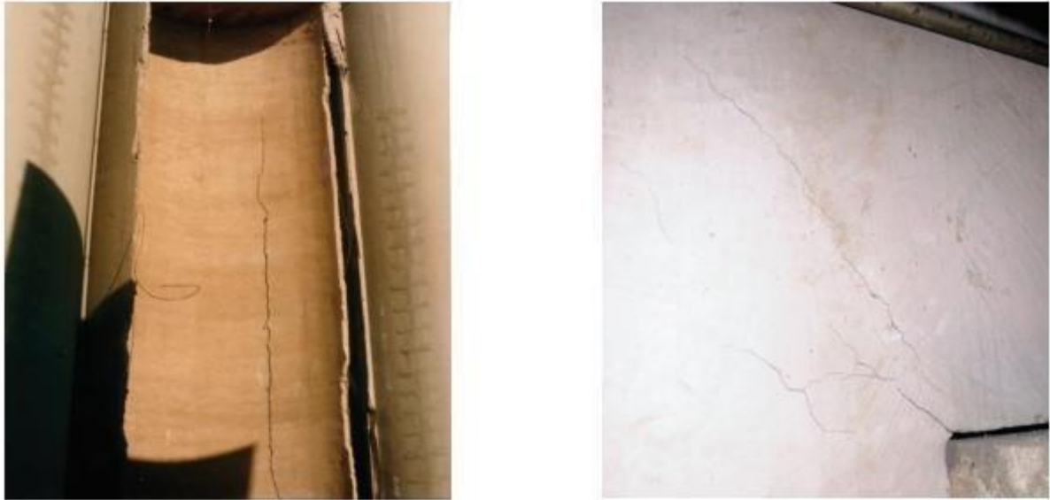
Figura 6 - Fissuras originadas por esforços externos
