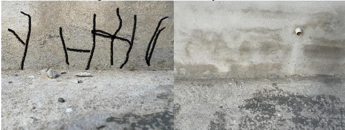
Figura 17 – Fissuras de retração térmica
