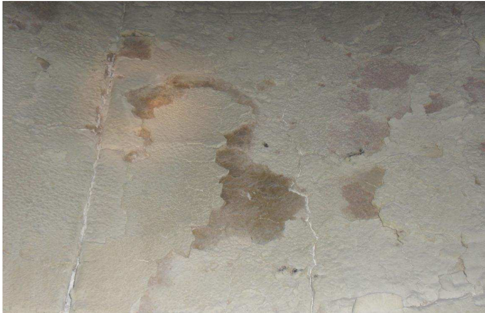
Foto 10 – Detalhe da região afetada pelo calor decorrente dos gases de combustão
