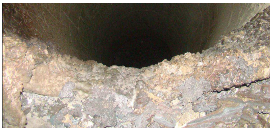
Foto 5 – Desgaste do refratário evidenciado na câmara de combustão
