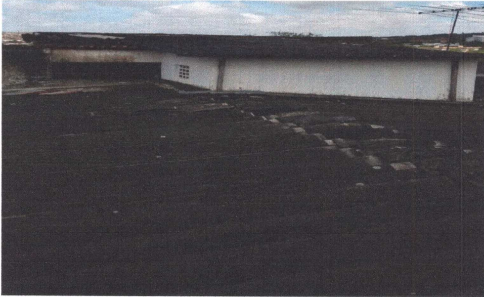
Figura 9 – Telhado da Biblioteca
