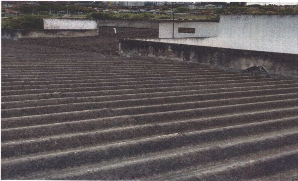
Figura 10 – Telhado da Biblioteca
