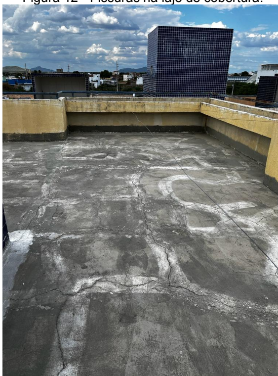
Figura 12 - Fissuras na laje de cobertura.
