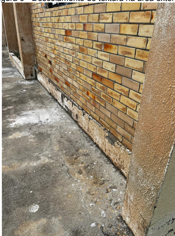
Figura 6 - Descolamento de textura na área externa.
