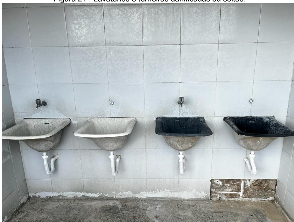
Figura 21 - Lavatórios e torneiras danificadas ou soltas.
