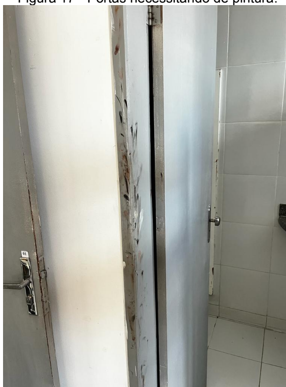
Figura 17 - Portas necessitando de pintura.
