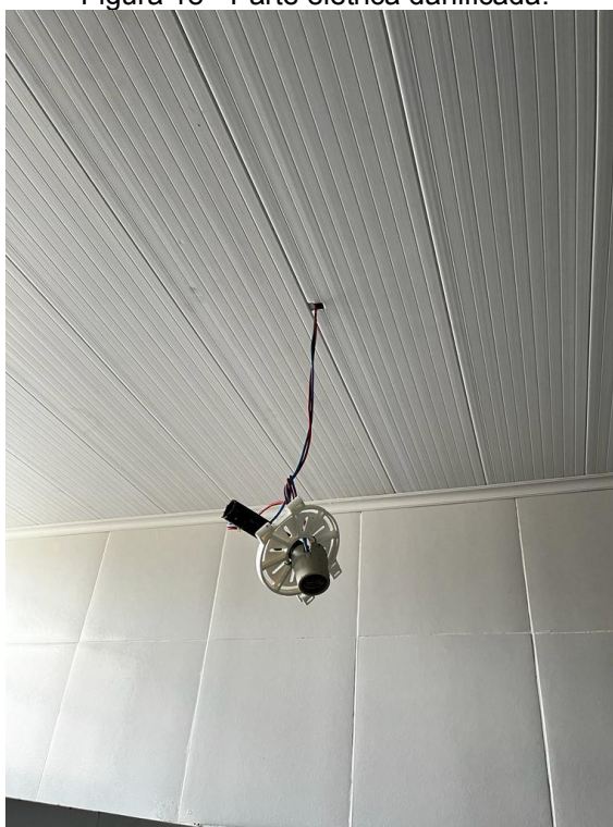
Figura 18 - Parte elétrica danificada.
