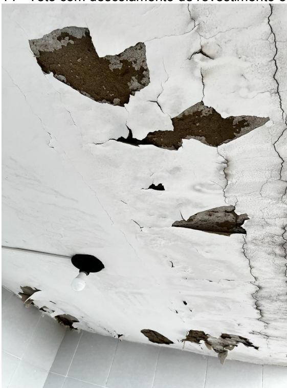
Figura 14 - Teto com descolamento de revestimento e pintura.
