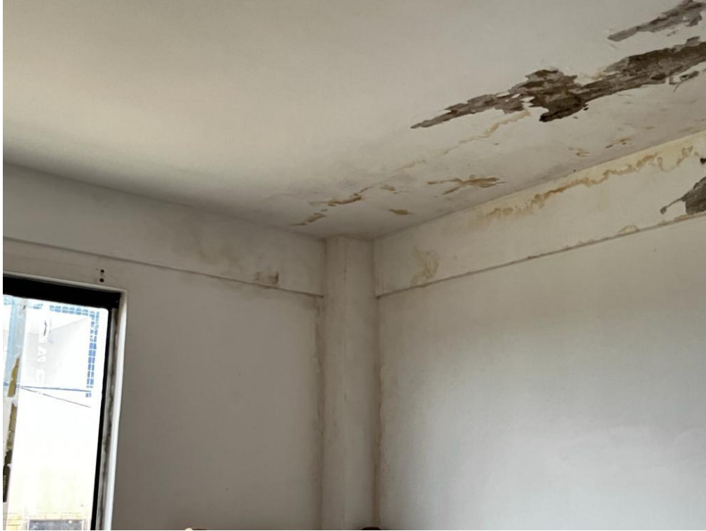
Figura 9 - Infiltração e umidade no teto dos dormitórios.
