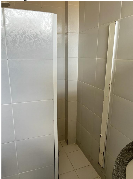
Figura 10 - Porta do box danificada.
