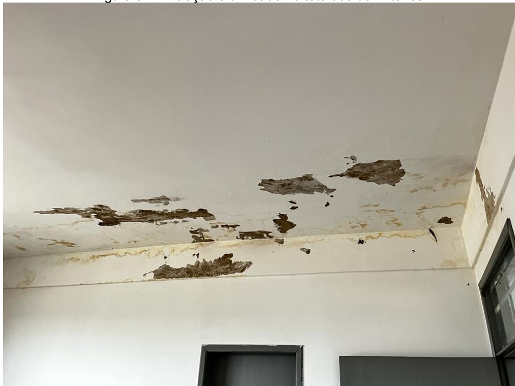
Figura 8 - Infiltração e umidade no teto dos dormitórios.
