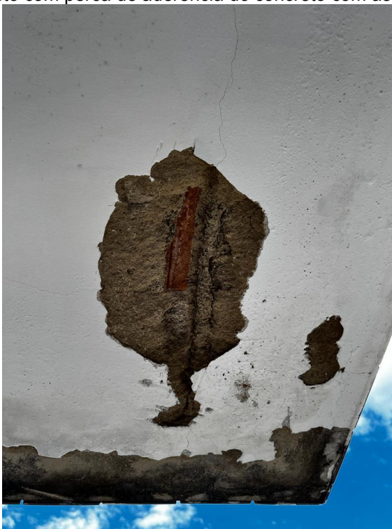
Figura 15 - Teto com perda de aderência do concreto com as barras de aço.
