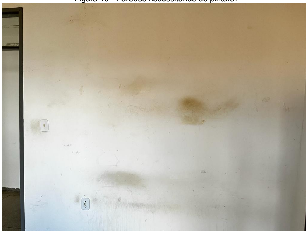
Figura 16 - Paredes necessitando de pintura.
