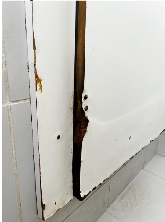
Figura 11 - Porta do box danificada.
