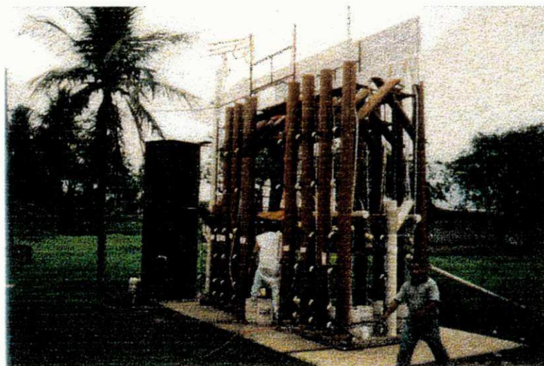
Figura 3.1 - Estrutura metálica onde os reatores foram fixados
