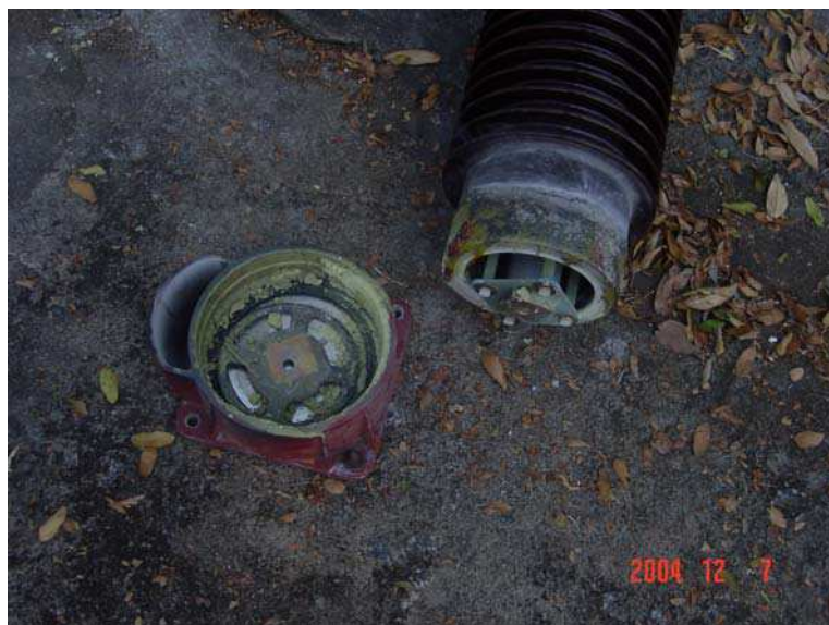
Fig. 25 – Base do pára-raios após abertura.
