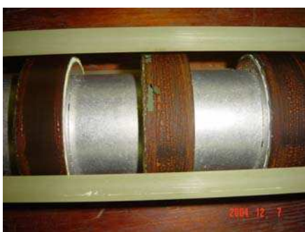
Fig. 35 - Degradação do isolamento lateral.
