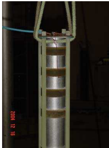
Fig. 44 – Curto-circuito sobre os dois primeiros varistores da coluna ativa.
