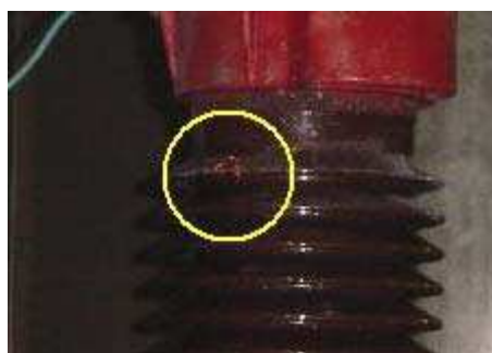
Fig. 83 – Descarga elétrica superficial em pára-raios coberto com poluição salina.
