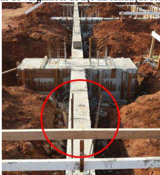
Figura 13. Esperas de vergalhões de aço na fundação sem proteção
