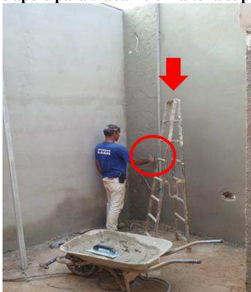
Figura 9. Improvise de apoio para trabalho em altura superior à 2 metros
