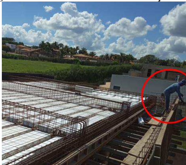
Figura 5. Trabalho em altura sem utilização de EPI
