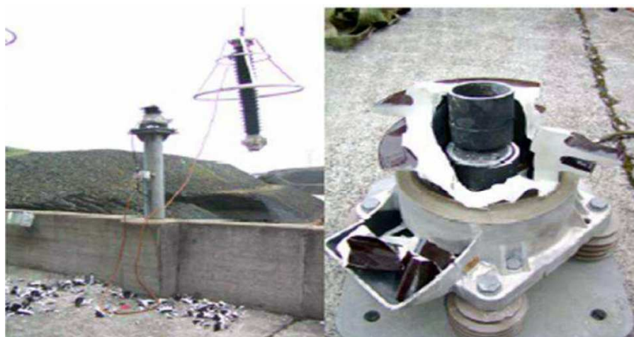
Figura 3.4 – Fotografia de para-raios após a explosão do invólucro (LARSEN; LIEN, 2007).
