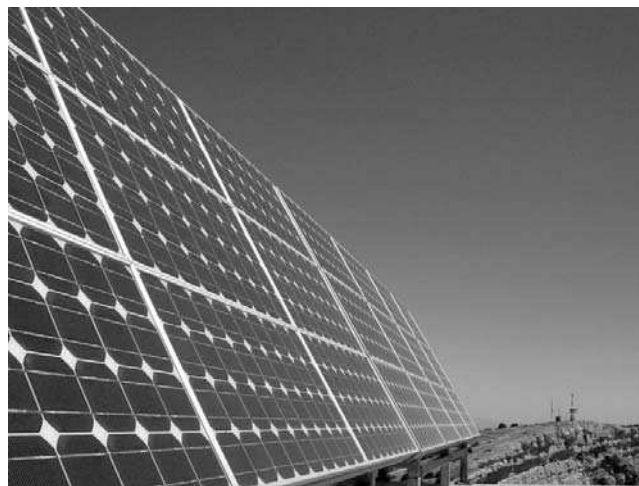
Figura B.8: Painel FV em operação.
