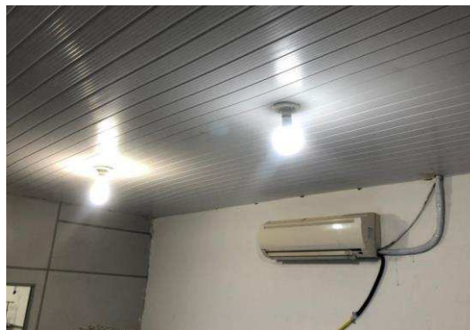
Figura 4 – Sistema de Ventilação e Iluminação
