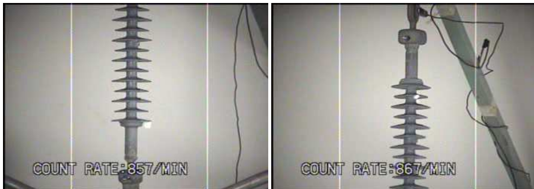
Figura 4.31. Imagens detectadas pela câmera UV para isolador sem defeito e poluição nível 3.
