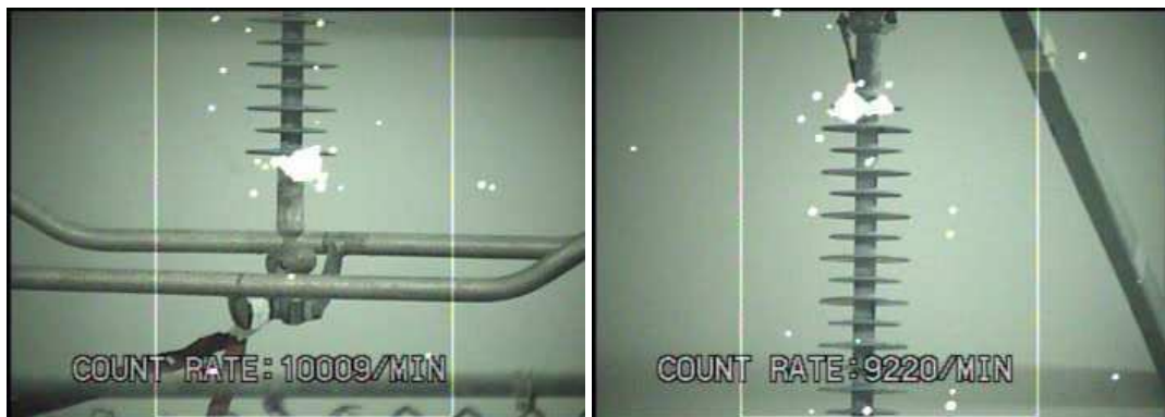
Figura 4.23. Imagens detectadas pela câmera UV para isolador com defeito e poluição nível 1.
