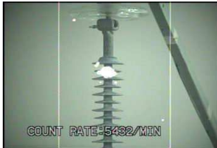
Figura 4.19. Imagem detectada pela câmera UV para isolador sem defeitos e poluição nível 1.
