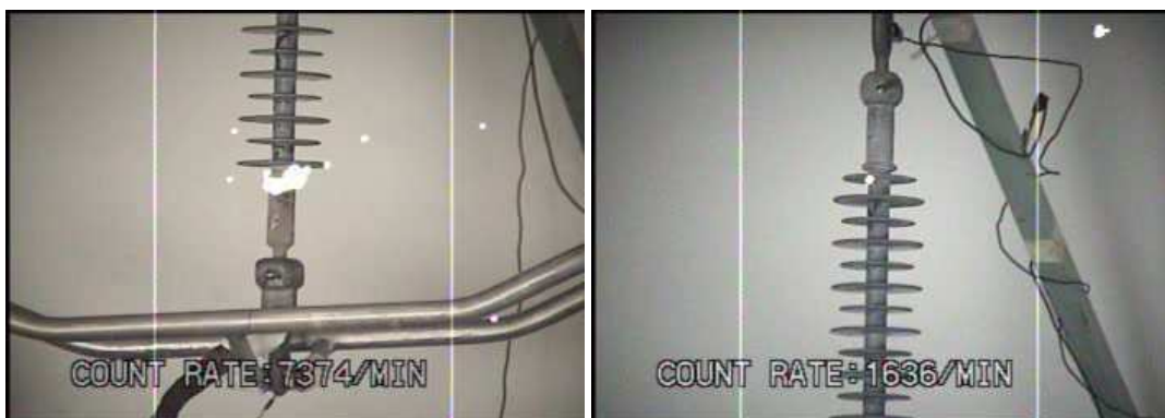
Figura 4.29. Imagens detectadas pela câmera UV para isolador com defeito e poluição nível 2.
