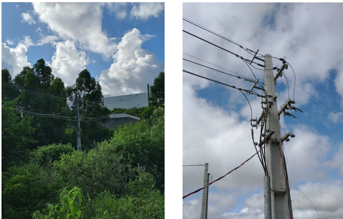
(a) Saída da rede elétrica da MOURA II - UN10 (b) Detalhe do poste de descida da rede
