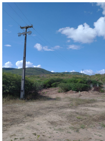
(b) Postes da rede rural Neoenergia
