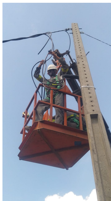
(b) Detalhes da passagem dos cabos
