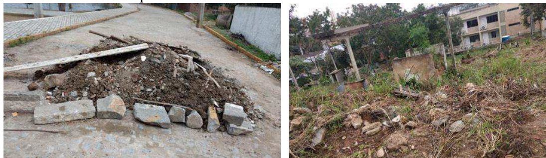
Figura 2. Disposição dos resíduos de construção e demolição no campus I da UFCG.
